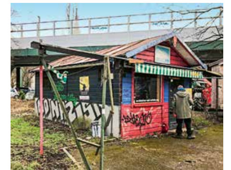
▲ Der Vorgängerbau war so marode, dass er sprichwörtlich von selbst zerfiel
